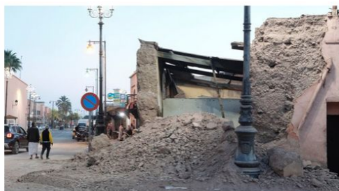
Les destrosses causades pels sismes
