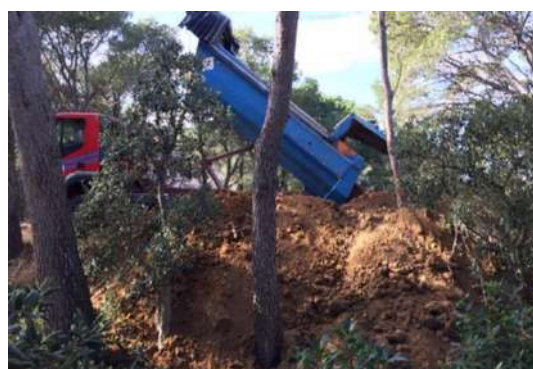
44. Abocaments a la muntanya de Sant Sebastià, inclosa a la moratòria.
