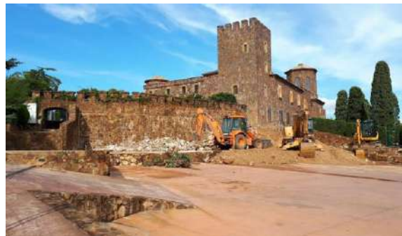
49. Màquines a Cap Roig encarregades de les obres de l'auditori semisoterrat adossat al castell.
