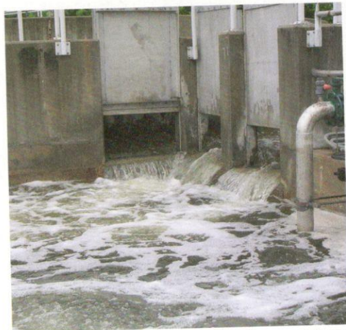
Depuradora d'aigües residuals
