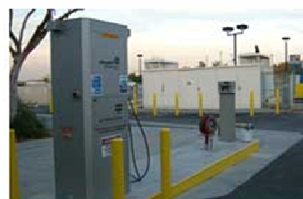
Garage Público. Primera estación de hidrógeno en California que utiliza un diseño de reponer combustible en forma de isla. Diamond Bar SCAQMD
