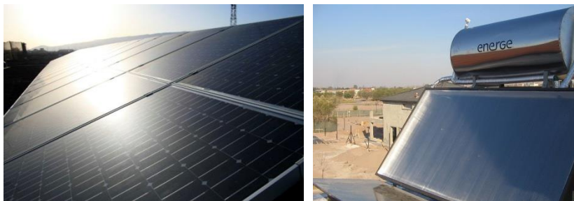
Fig.10 Aprofitament de l'energia solar: plaques fotovoltaiques i plaques tèrmiques
