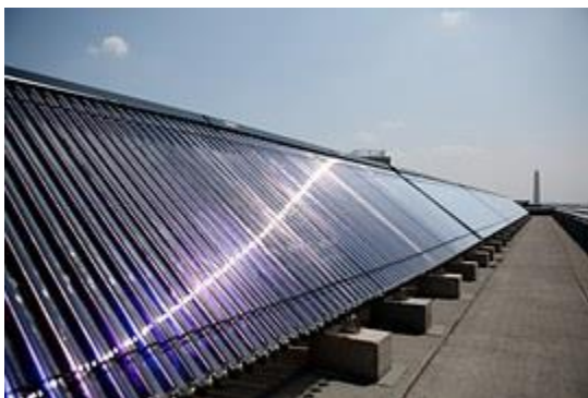
Fig. 3.2. Instal·lació de panells tèrmics tubulars de baixa temperatura. Font: https://goo.gl/7go4WW
